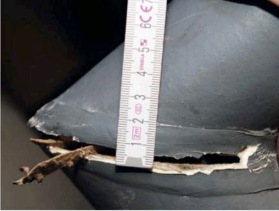
Risse in Luftzuleitungsrohren
